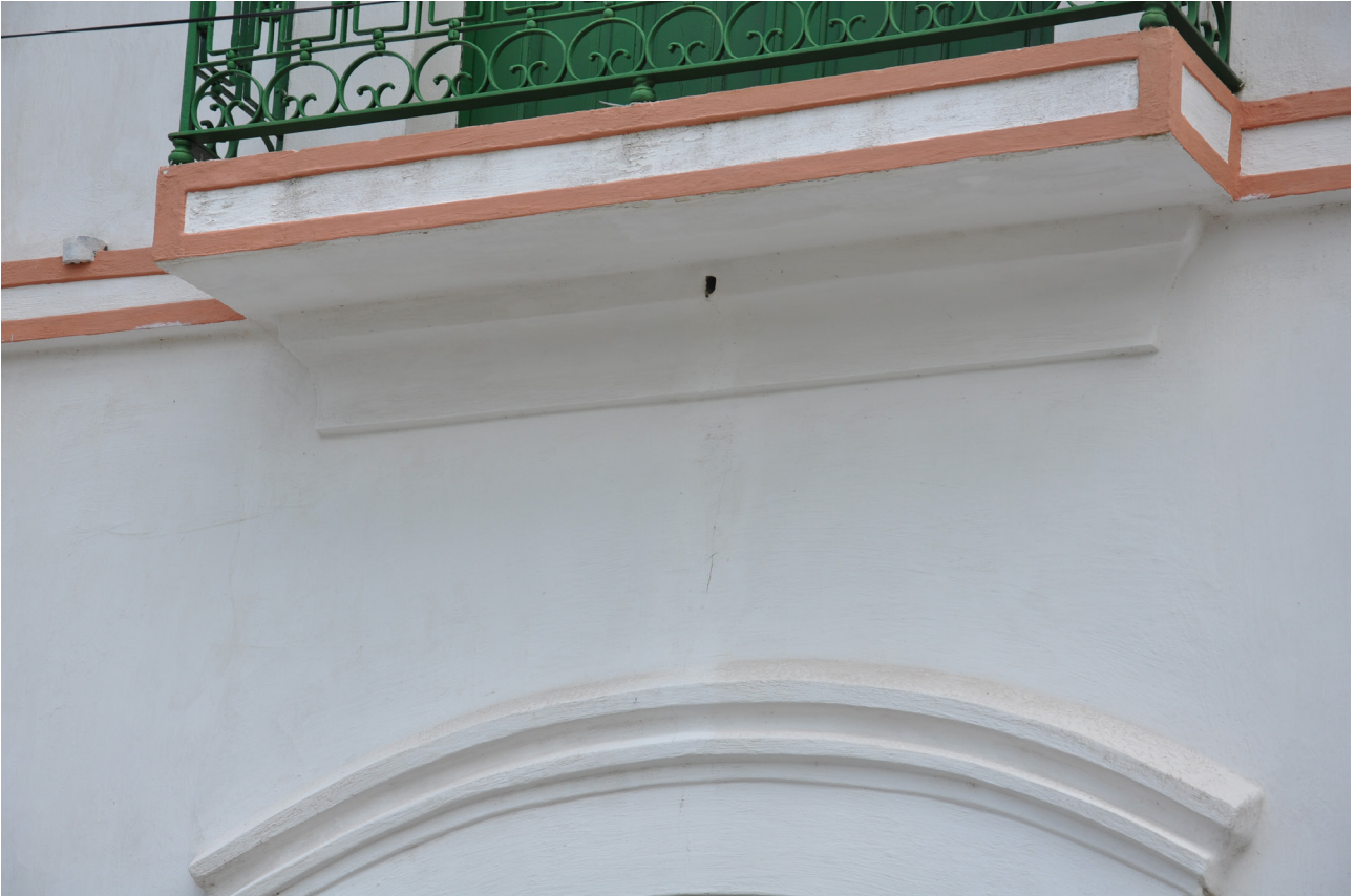
Saída do escoamento do balcão na fachada.
