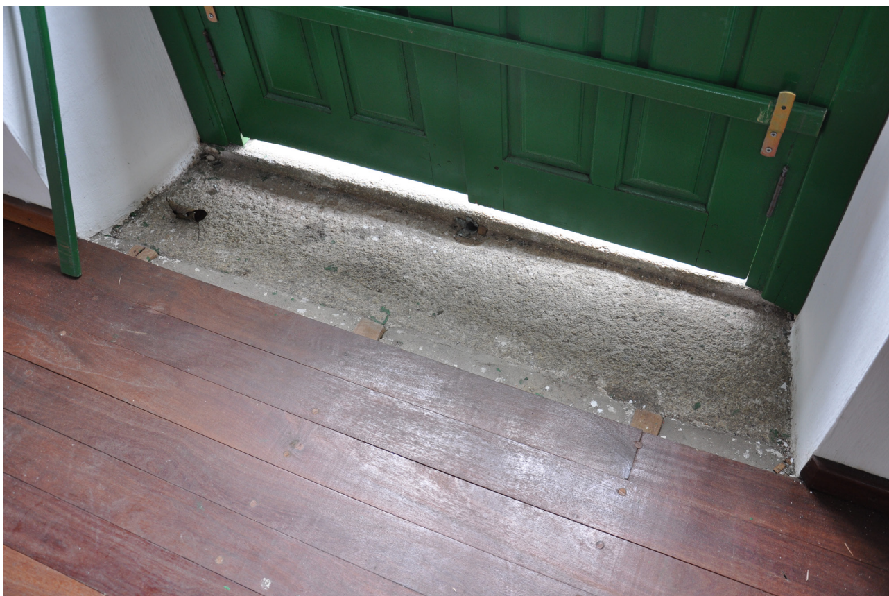
Rebaixo existente no acesso ao balcão.
